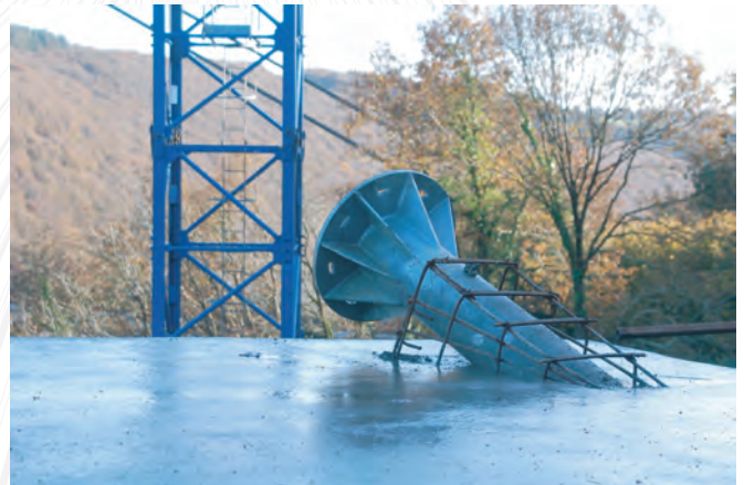
Tube coffrant d'un hauban fixé dans le tablier.
