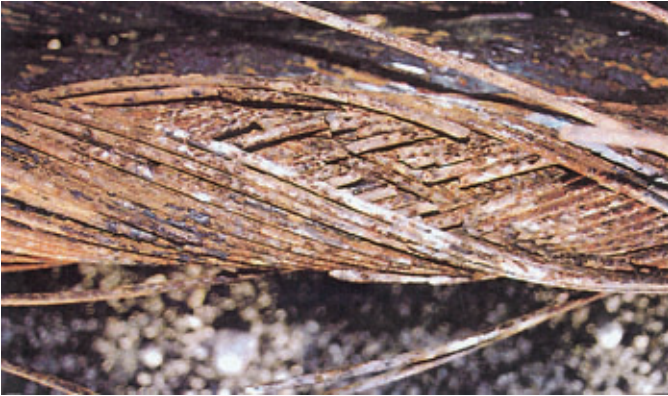
Photo 8 Portion de câble ancien après dépose Portion of old cable after removal
