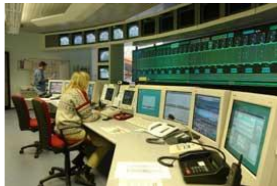
Salle de commande du tunnel Mont-Blanc (après rénovation)
