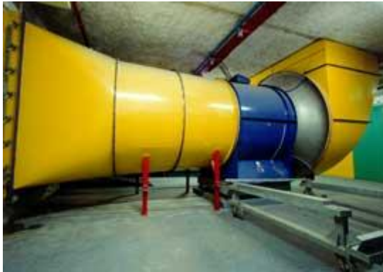
Un ventilateur d'extraction des fumées hors d'un tunnel
