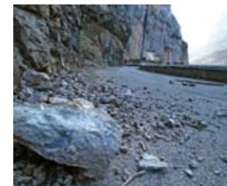
Les chutes de pierres sur la chaussée y sont quotidiennes
