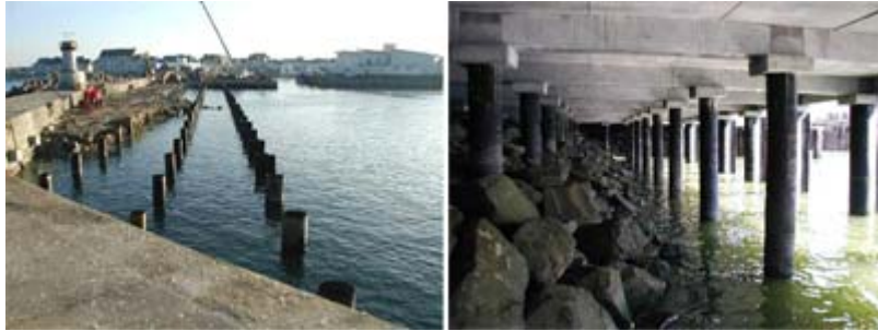
Fondations d'un quai et quai construit sur les pieux précédents (Droits réservés)
