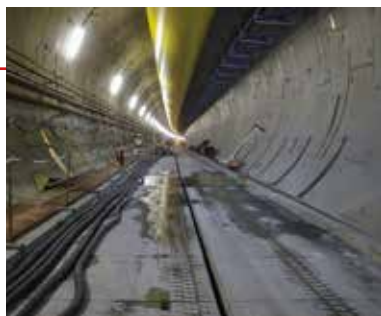
p. 25 – Dans le tunnel Lyon-Turin, les galeries de reconnaissance sont creusées au tunnelier.
