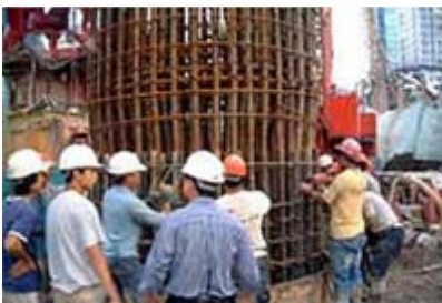
Cage d'armature de 3 m de diamètre pour fondations d'une tour de Hong-Kong (Droits réservés)
